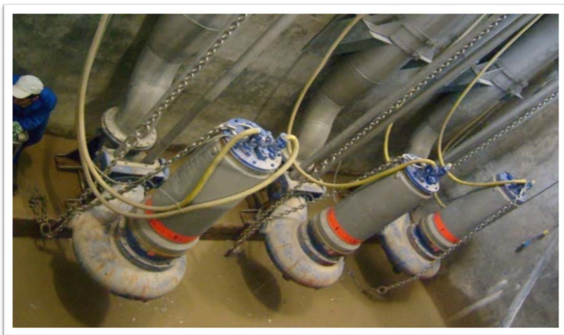
Figure 01 : Station de relevage des eaux brutes
