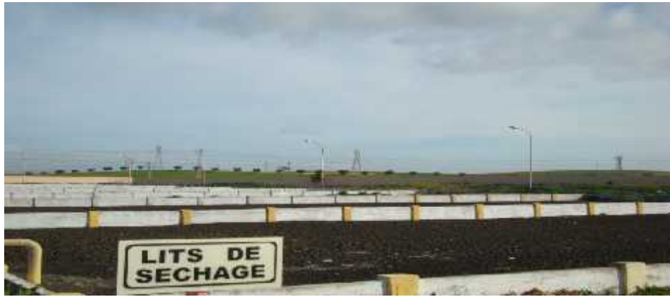
Photo 20- Les lits de séchage (Amar S., 2015).
