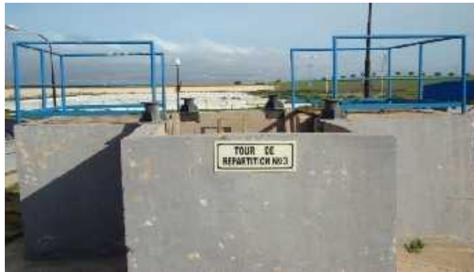
Photo 15 - Tour de répartition N° 3 (Amar S., 2015).
