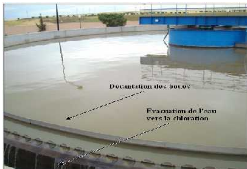
Photo 16- Décanteur secondaire (Amar S., 2015).
