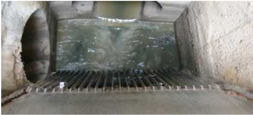
Photo 9 - La grille grossière de la STEP (Amar S., 2015).
