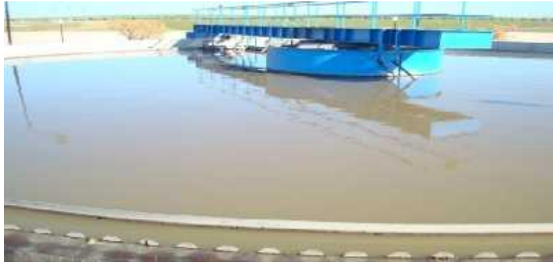
Fipfoto 13- Le décanteur primaire de la STEP (Amar S., 2015).
