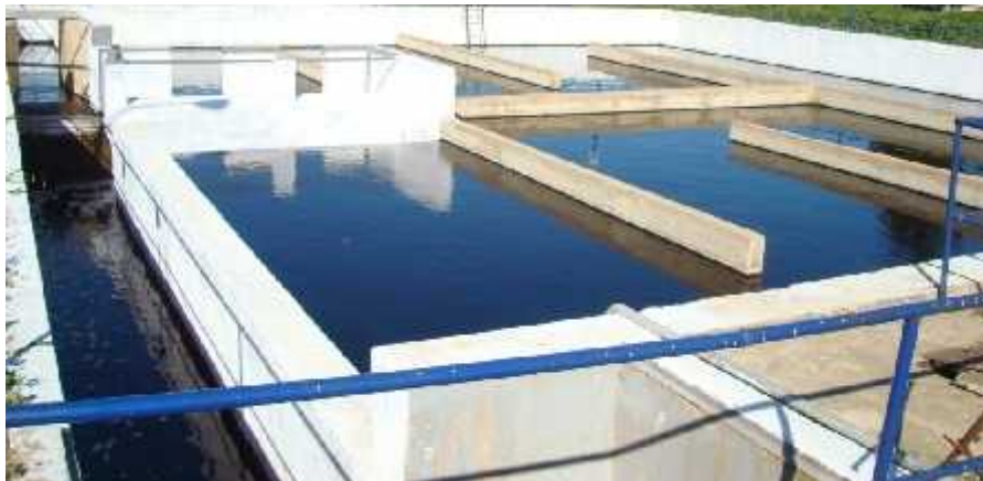
Photo 17- Bassin de chloration (Amar S., 2015).
