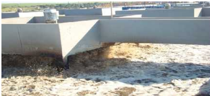
Photo 14 - Bassin d'aération (Amar S., 2015).
