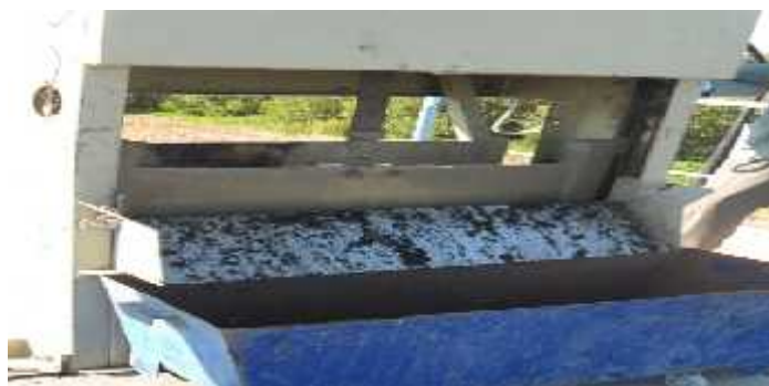
Photo 10 - Dégrilleur (Amar S., 2015).
