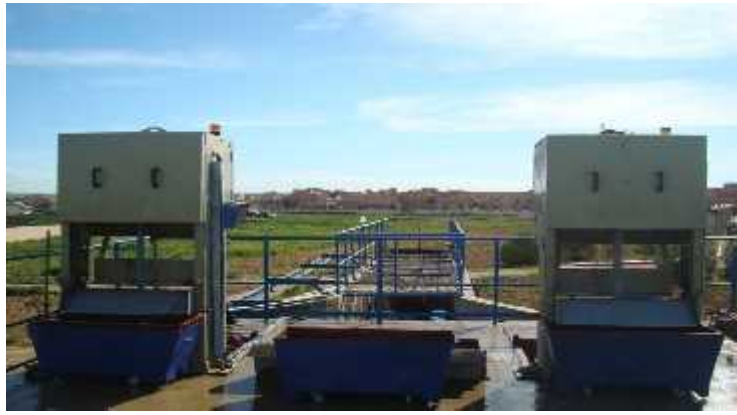
Photo 11 - Les deux grilles mécanisées de la STEP (Amar S., 2015).
