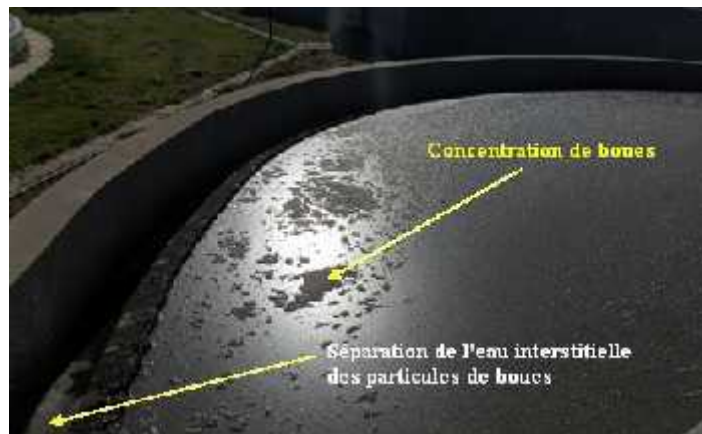
Photo 19 - Epaisseur des boues (Amar S., 2015).
