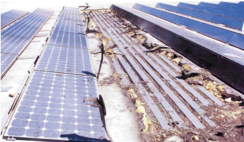
Figure 4. 1 Risque d'incendie dans un générateur photovoltaïque de 383 kW, à Bakersfield, Californie 2009 (Brooks, 2011).
