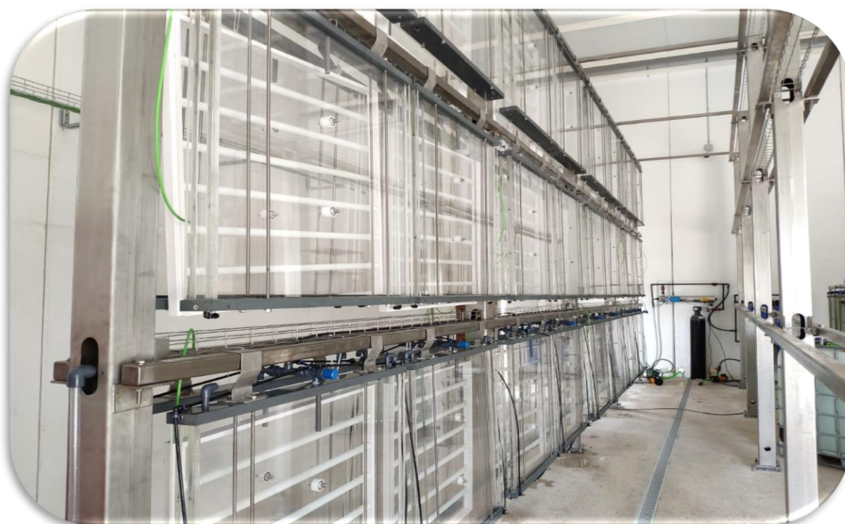
Fig 50 : Disposition Verticale de trois étages de Photobioréacteur Crevillante Alicante
