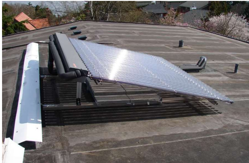
Figure I.1 Capteurs vitrés sombres (France) d'un chauffe-eau solaire dans lesquels circule le fluide caloporteur. © Seattle.roamer, Flickr, cc by nc nd 2.0
