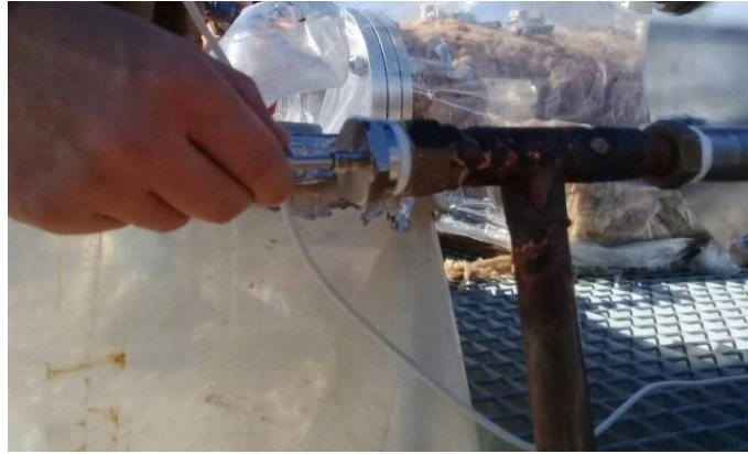
Figure 4.22 Capteur de température RTD dans le circuit hydraulique.
