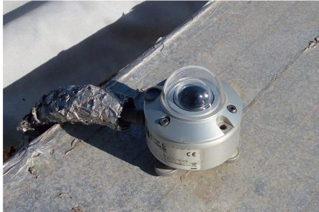
Figure 4.23 Montage du pyranomètre.
