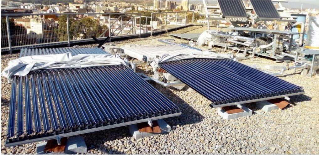
Figure 4.3 Collecteurs solaires VITOSOL 300-TM.
