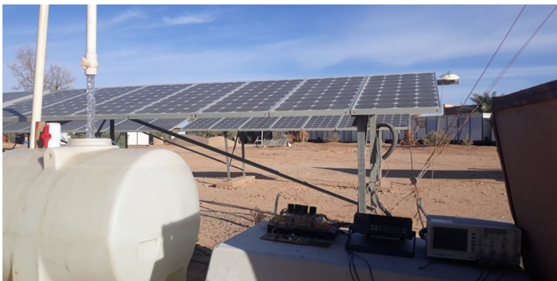
Figure IV.34 : Système de pompage PV expérimenté sur site réel (URER/MS-CDER)
