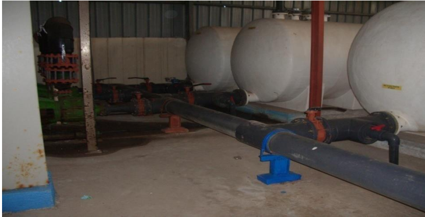
Figure 61 - Point de Prélèvement d'eau osmosée. (Cas de la station de Bouzedjar )
