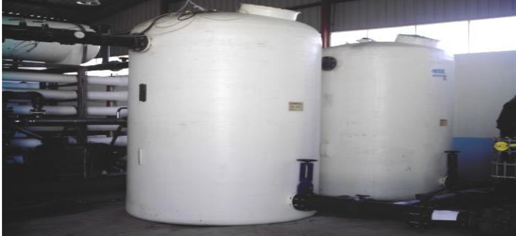
Figure 10- Réservoir de pompage (Cas de la station de Bouzedjar)
