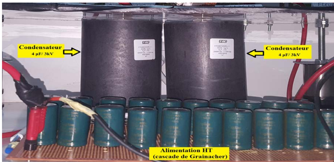
Fig. 4.5: Condensateurs de stockage d'énergie et l'alimentation HT
