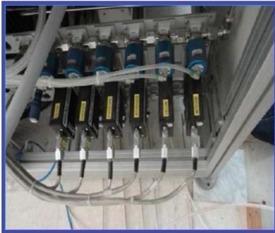
Figure IV.2 : Branchement des débitmètres des gaz toxiques et inflammables.
