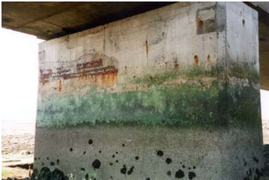
Figure I.2: Corrosion des armatures d'une pile de pont (AF CG, 2003)
