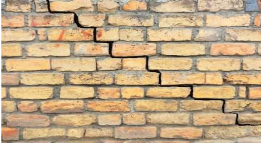
Figure I.7: Fissures en forme d'escalier sur un mur de bâtiment
