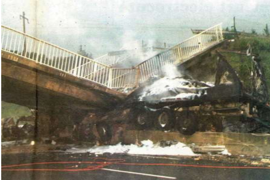
Figure I.5: Effondrement d'un pont lors d'un violent choc de poids lourd (CETE, 2009)
