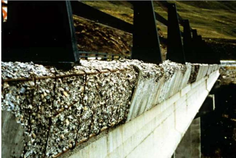
Figure I.8: Écaillage et éclatement de béton sur corniche de tablier (SETRA)
