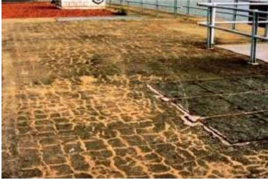
Figure I.1: Faïençage résultant d'une alcali-réaction (Caluwé et al, 2008)
