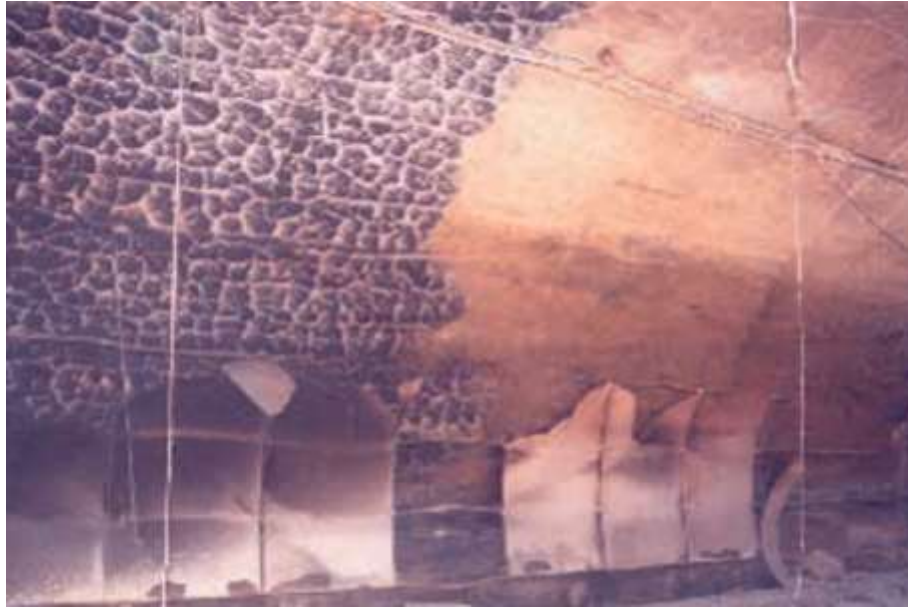
Figure I.6: Béton faïencé dans un tunnel suite à un incendie (CETU, 2015)
