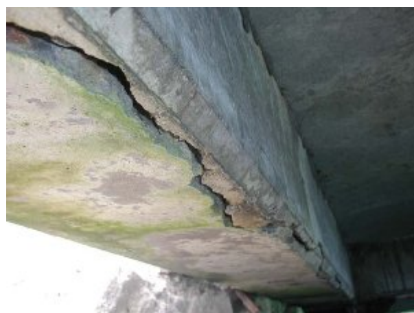
Figure I-12 - Fissuration du béton d'une poutre due au gonflement des armatures
