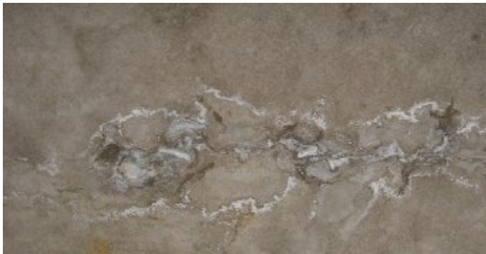
Figure I-8 Précipité de calcite suite à un lessivage du béton
