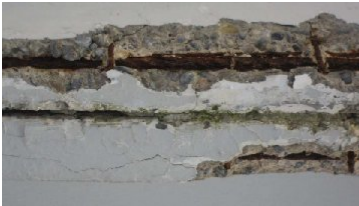
Figure I-6 L'état de corrosion des armatures (Par carbonatation) sur une poutre d'auvent en béton armé.
