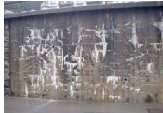
Figure I-4 - Dégâts de RAG d'un mur de soutènement
