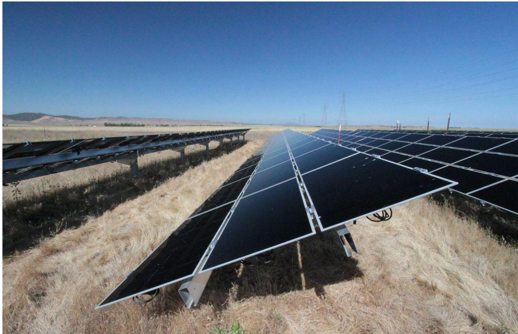
Figure (II.7): La plus grande centrale PV au monde (USA) [CAL-2016].
