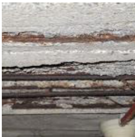
Figure I.3: Dégradation par corrosion des armatures
