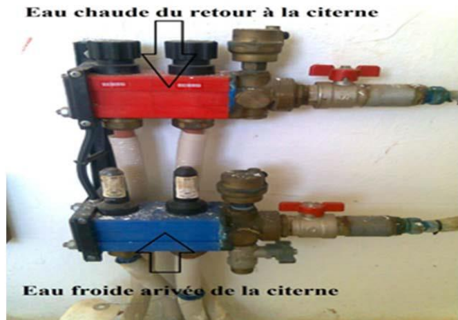
Figure II.13 : Collecteur de raccordement avec le circuit hydraulique [69].
