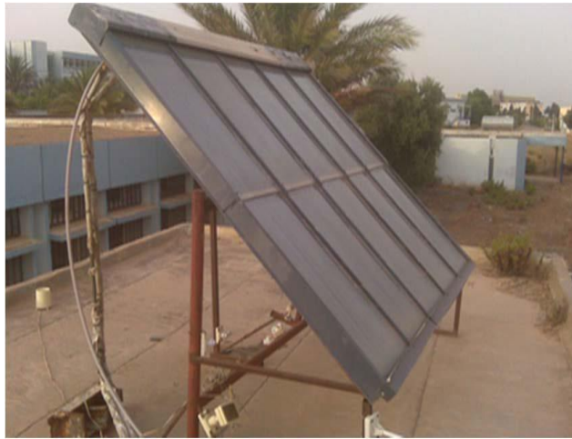
Figure II.11 : Capteur solaire thermique vitré [69].
