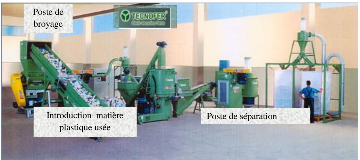
Figure 1.17 : Exemple d'installation industrielle de récupération et de séparation des produits plastiques [docs TECNOFER, Italie].
