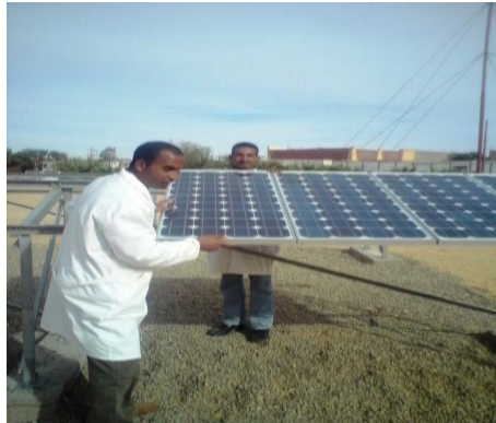
Figure III.3 : Système de pompage photovoltaïque installé à URER/MS
