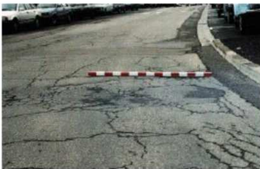
Figure 1.22 : Fissure en dalle
