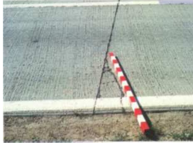
Figure 1.20 : Cassure d'angle *cassure dégradée avec départ de matériaux*
