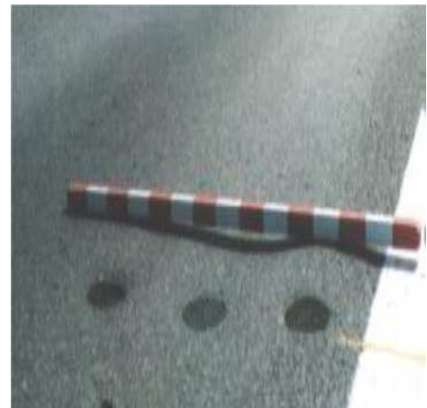
Figure 1.12 : orniérage à petit rayon
