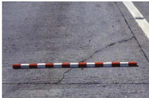
Figure 1.23 : Fissure en coin de dalle
