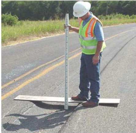
Figure 1.11 : Exemple d'une chaussée atteinte d'orniérage
