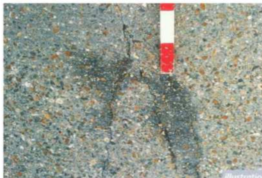
Figure 1.17 : Fissure diverse en Y
