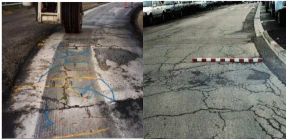
Figure 1.9 : Remonté à la surface des fissures de fatigue
