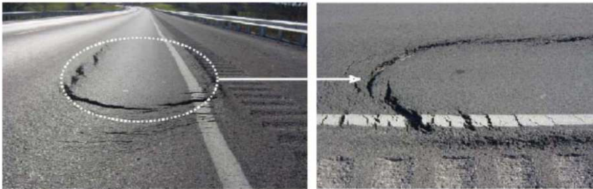
Figure 1.10 : Exemple de dégradation due à un défaut de collage à l'interface
