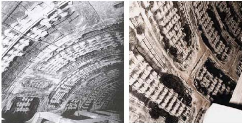
Figure I.14 : Photos des voussoirs du tunnel sous la Manche prises après l'incendie de 1996.[11-13 ]
