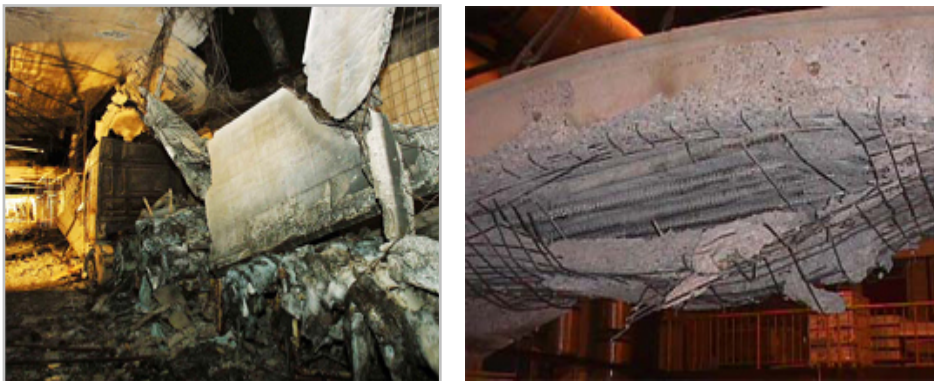
Figure I.13 : Eclatement du béton lors d'un incendie.[14]
