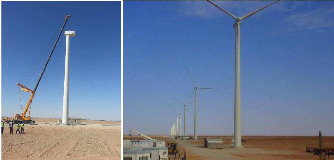
Fig.1.5 - La ferme éolienne de 10MW à Kabertène (Adrar).
