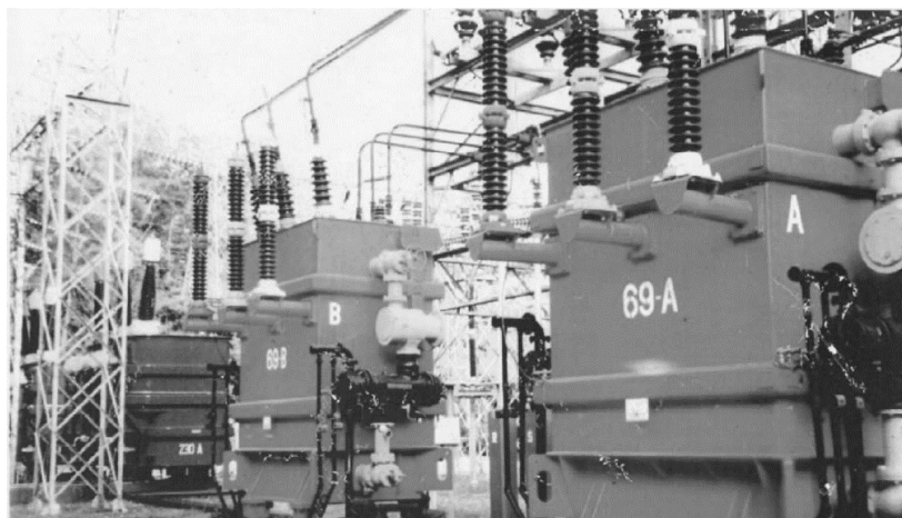
Figure 1.10 Transformateurs de puissance d'une sous-station.
